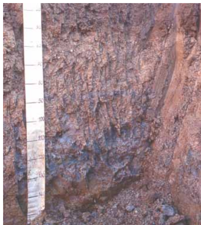
Fig.3: Evidenti screziature grigie e rossastre presenti in profondità dovute all'alternanza di condizioni riducenti e ossidanti per l'oscillazione stagionale della falda.
